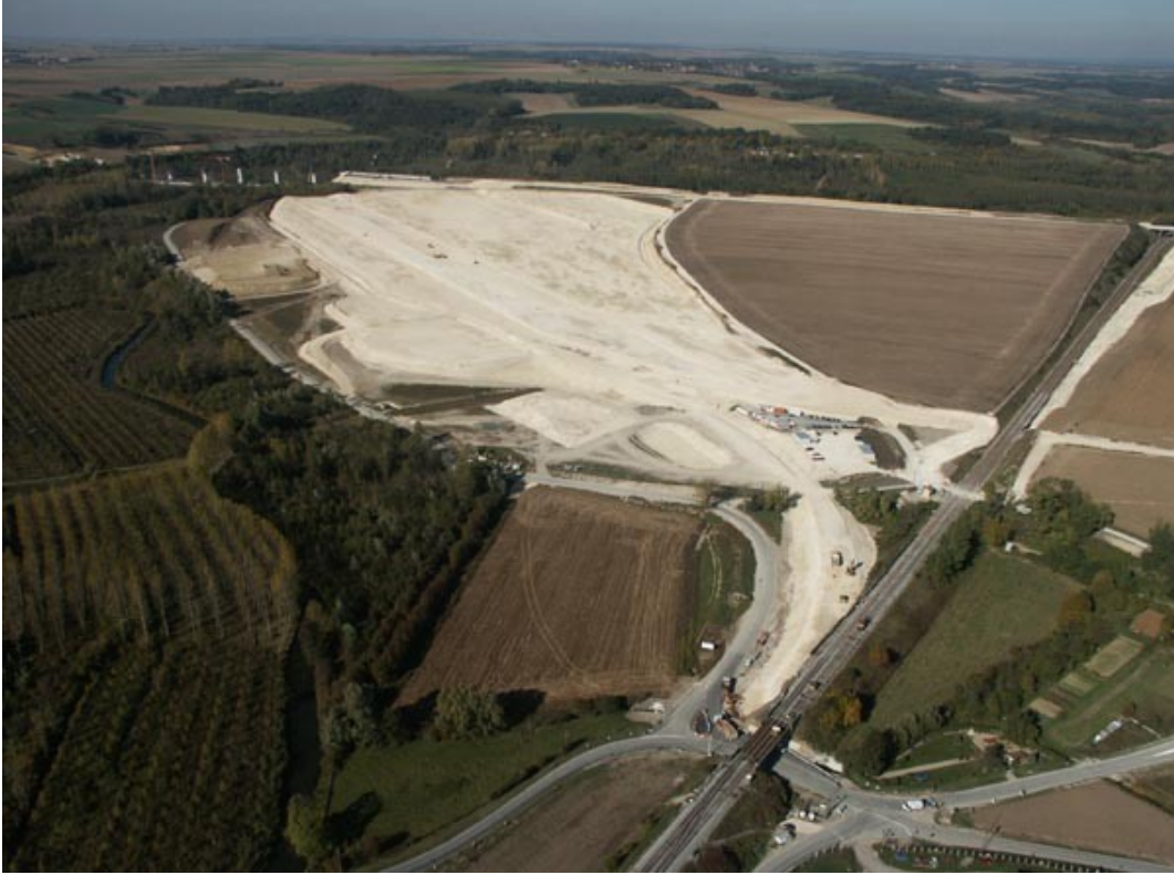
Base d'équipements ferroviaires d'Ocquerre (Photo FNTP)
