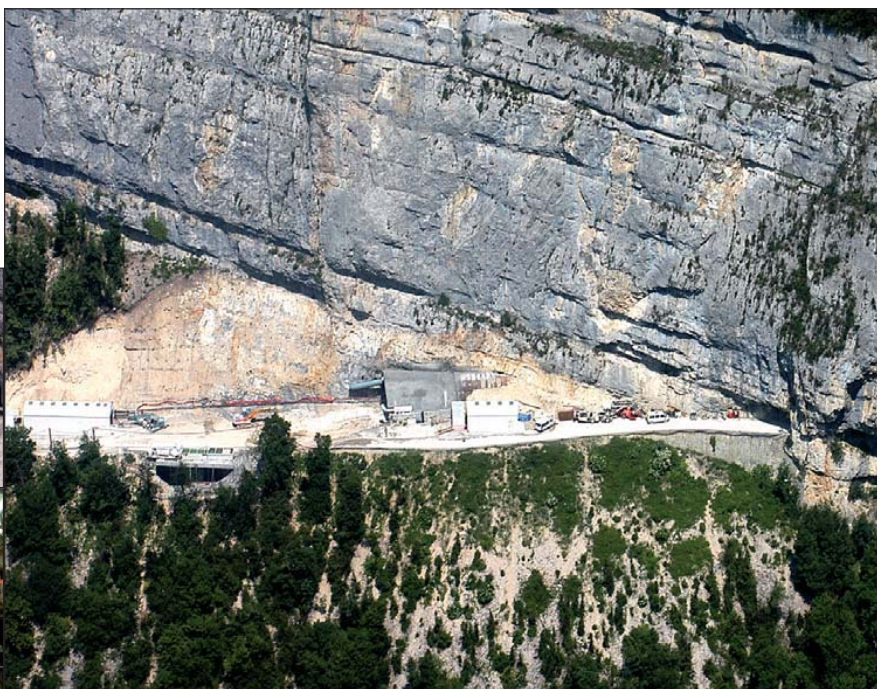
Le chantier côté aval vu du belvédère des rochers d'Echevis à 1160 m. 400 mètres de montagne s'élèvent au-dessus du tunnel et de la route des Grands Goulets.
